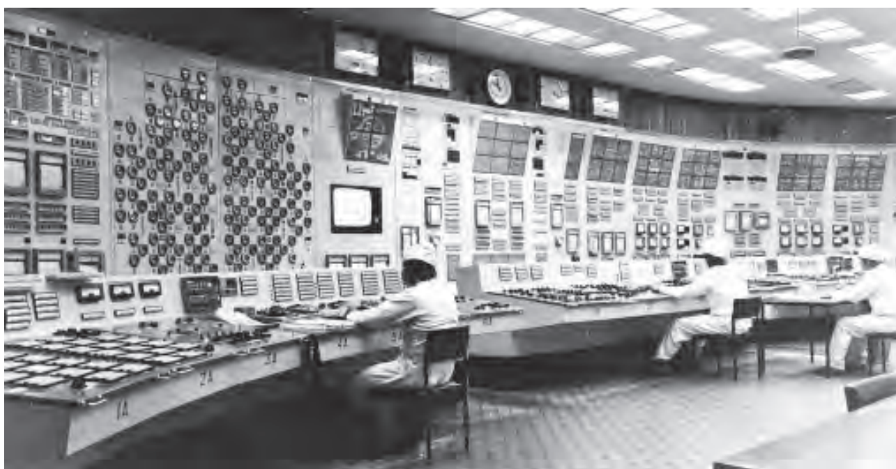
Главный пульт управления первого блока Ленинградской атомной станции
